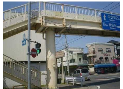
老朽化した歩道橋
