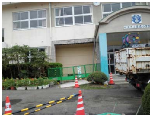
工事が中断した星鹿小学校
